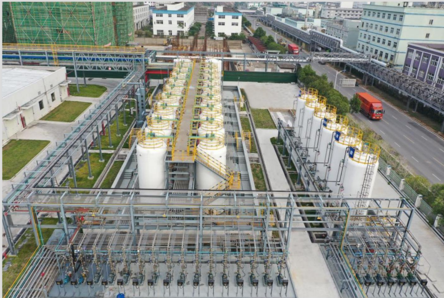
二厂区原料储罐
